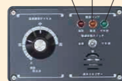
【操作パネル】油焚 電源 マキ焚
